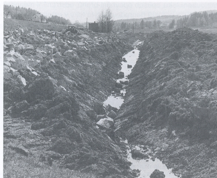
První fáze technické úpravy potoka po proříznutí meandrů. Nadměrné zahloubení nového koryta je zřejmé.
