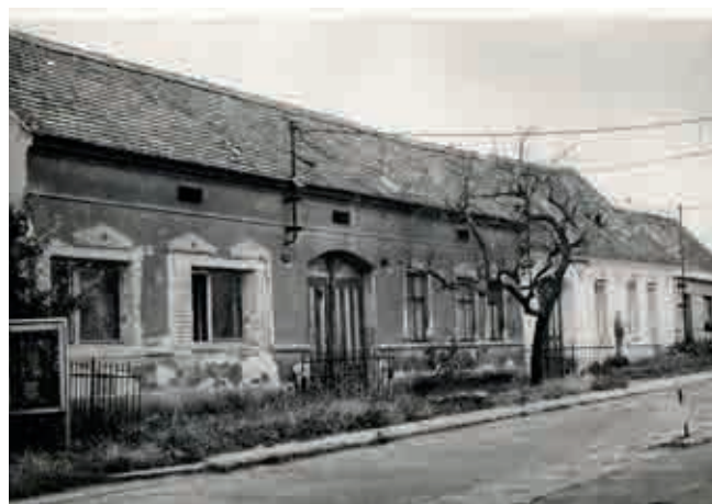
Prvními změnami k „modernizaci“ byla postižena okna, na vzhled budovy se nehledělo. Byť bylo původní členění průčelí řemeslně dokonalé a výtvarně půvabné, bylo v trendu doby je odstranit a na celou plochu natáhnout šedivý břizolít.
